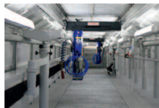
16. Fosse de maintenance pour collecter des huiles usagées
