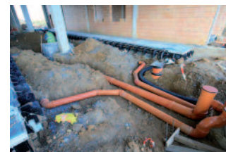
11. Branchement des périphéries de fosse de maintenance
