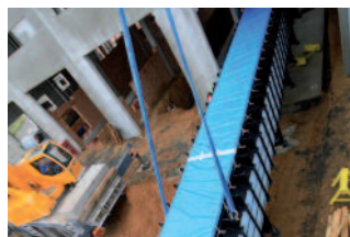
9. Manutention de fosse de maintenance sur la plaque de maintenance dans un hall déjà existant
